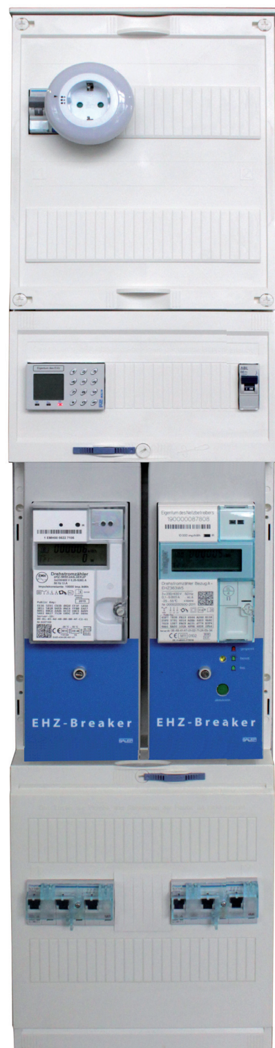
EHZ-Breaker in Neuanlage
